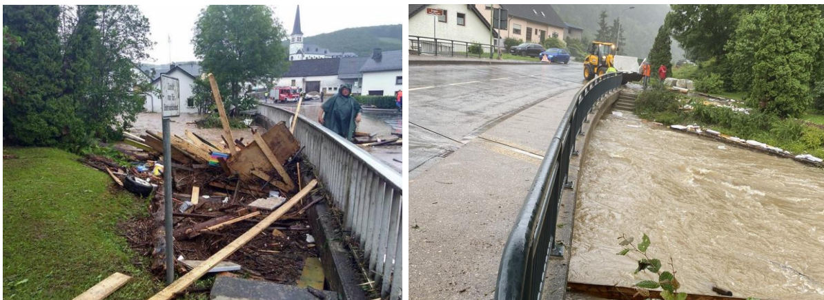
Abbildung 32: südliche Irsenbrücke an der B 410, links: 2018, rechts: 2021
