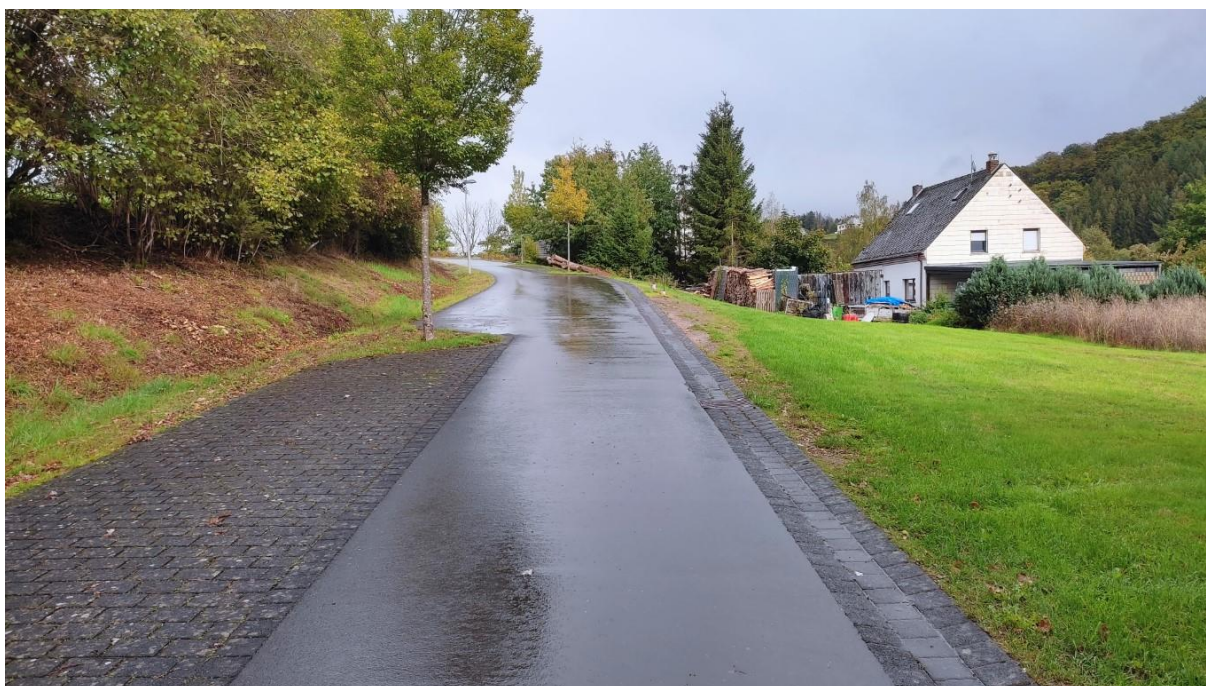
Abbildung 63: Entwässerung der Gemeindestraße „In der Bringsmich“, fehlende Bordsteine neben der dreizeiligen Rinne
