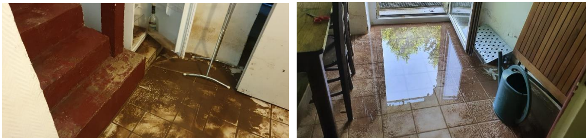
Abbildung 51: Überflutungen im Untergeschoß des Gebäudes Mattelbach Nr. 1
